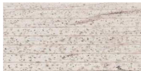
Stockflecken/Schimmel auf der Oberfläche
